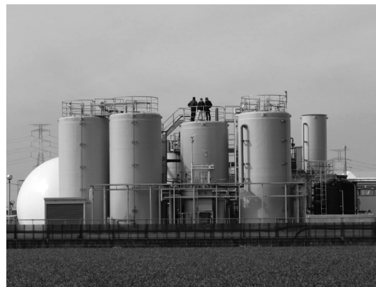
図4 大豆製品製造排水の嫌気性処理設備
